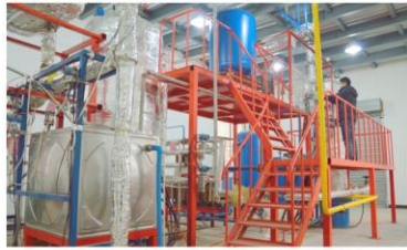
大型先进压水堆ADS-4喷放泄压系统平台
